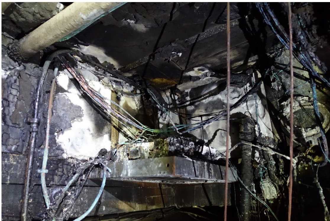
Foto 4. Hyllan för startbatterierna samt batteriladdare
