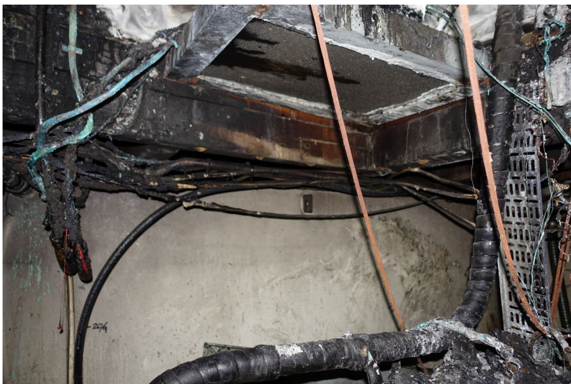
Foto 6. Panelen under batterihyllan visar att branden höll sig relativt högt upp
