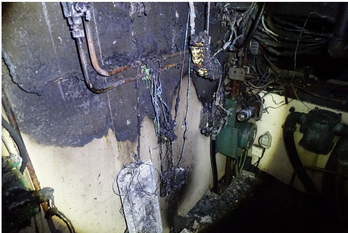
Foto 3. Främre maskinrums skottet med 24 volts säkringspanelpanelen
